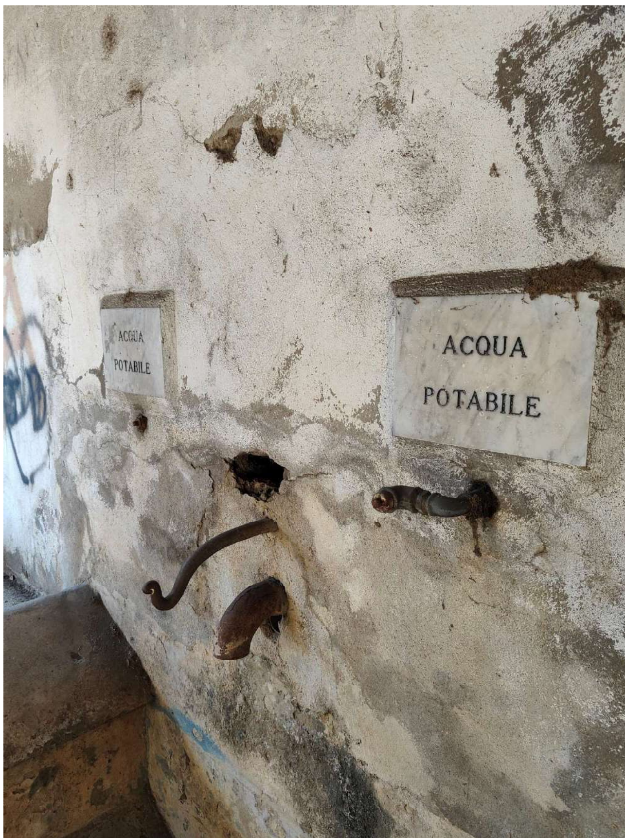
Sistema di erogazione dell'acqua storico e recente (dismesso)
